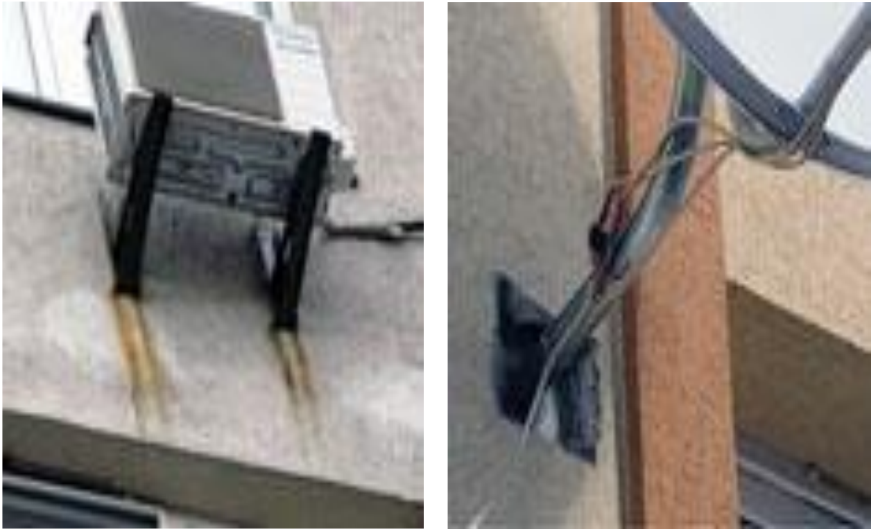
Рис.2.1 Приклад руйнування системи утеплення внаслідок порушень монтажу по системі теплоізоляції.
