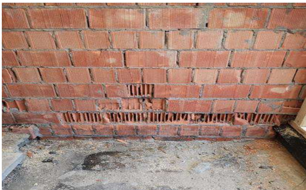
Рисунок 1.7 – Руйнування стіни з порожнистих блоків
