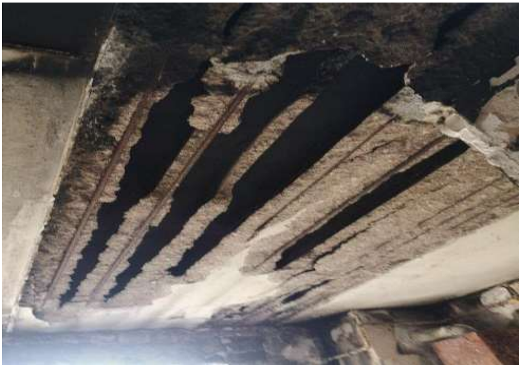
Рисунок 1.9 – Руйнування плит перекриття від дії вогню
