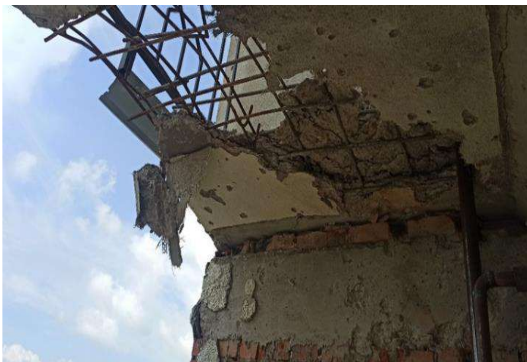
Рисунок 1.2 - Руйнування балконної плити
