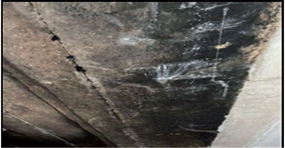
Рисунок 1.8 – Вогневе пошкодження плит перекриття
