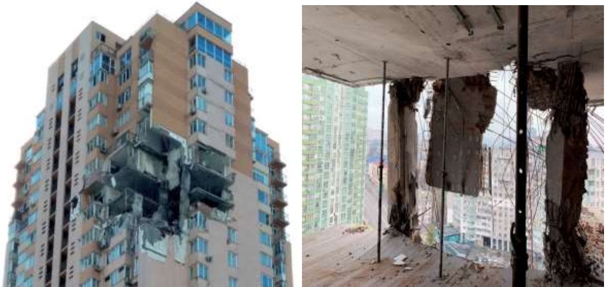
Рисунок 2.1- Руйнування кутової частини багатоповерхового житлового будинку
