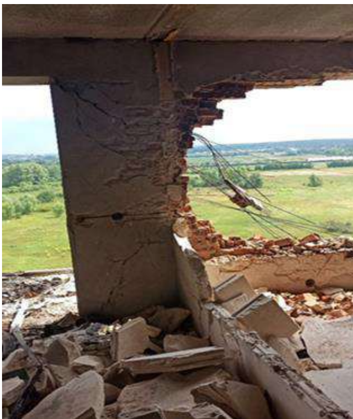
Рисунок 1.1 - Руйнування цегляного простінка
