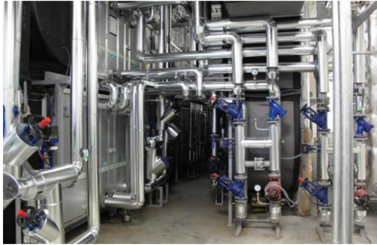
Рис. 10 Ефективна теплоізоляція трубопроводів
